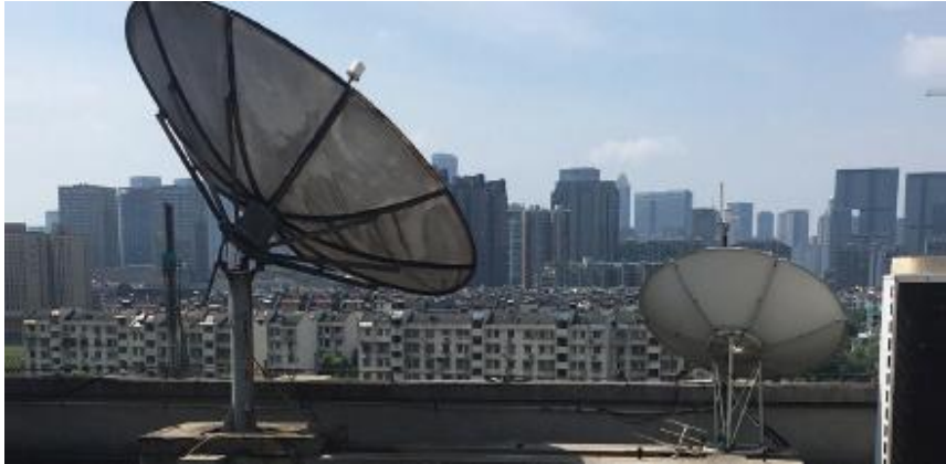
图 5 某省气象服务中心卫星通信系统
