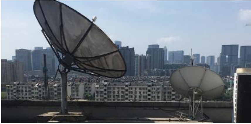
图 5 某省气象服务中心卫星通信系统
